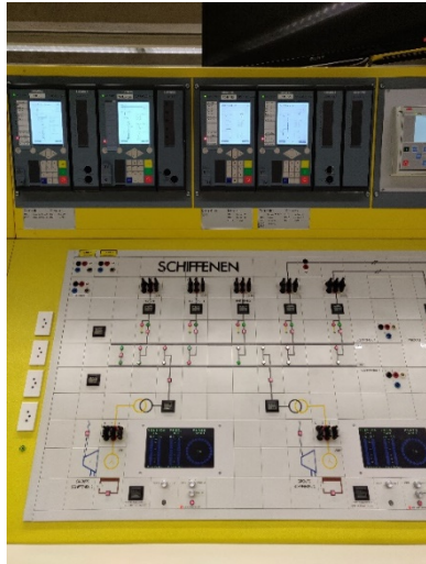
Figure 5 : Mini-réseau avec relais de protection du type Siemens SIPROTEC 5 du poste de Schiffenen
